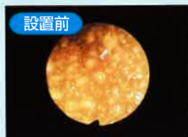
管壁が見えないほど、赤サビが内側を被っている
