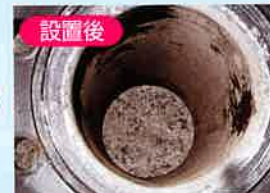
約3ヶ月後、管壁に付着していたスケールが、剥がれているのを確認
