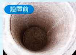
管壁内面に白くスケールが全体的に付着
