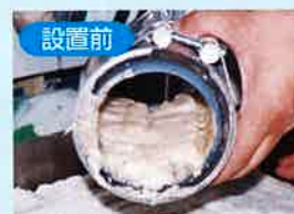
試験配管を取り外し、内部の尿石付着状況を確認
